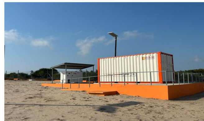
Geração de Bazatuto (200kW)- Inhambane
